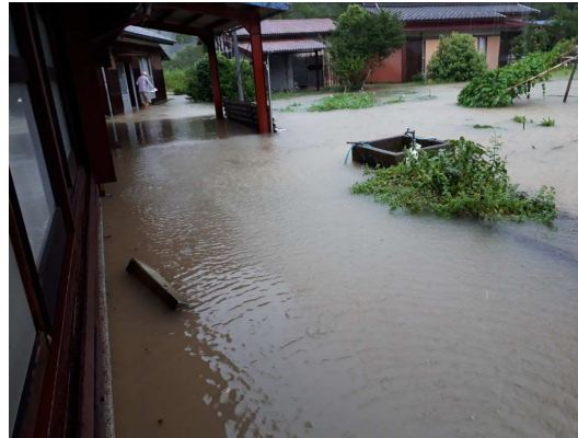
西日本豪雨で床下浸水した大池さんの自宅
